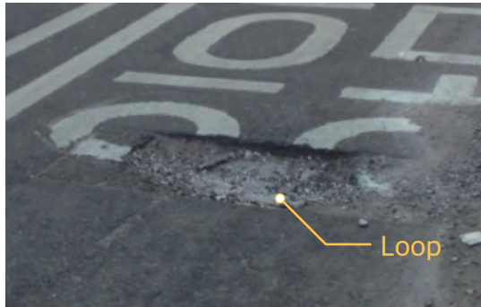
▲ Daño de ruta
